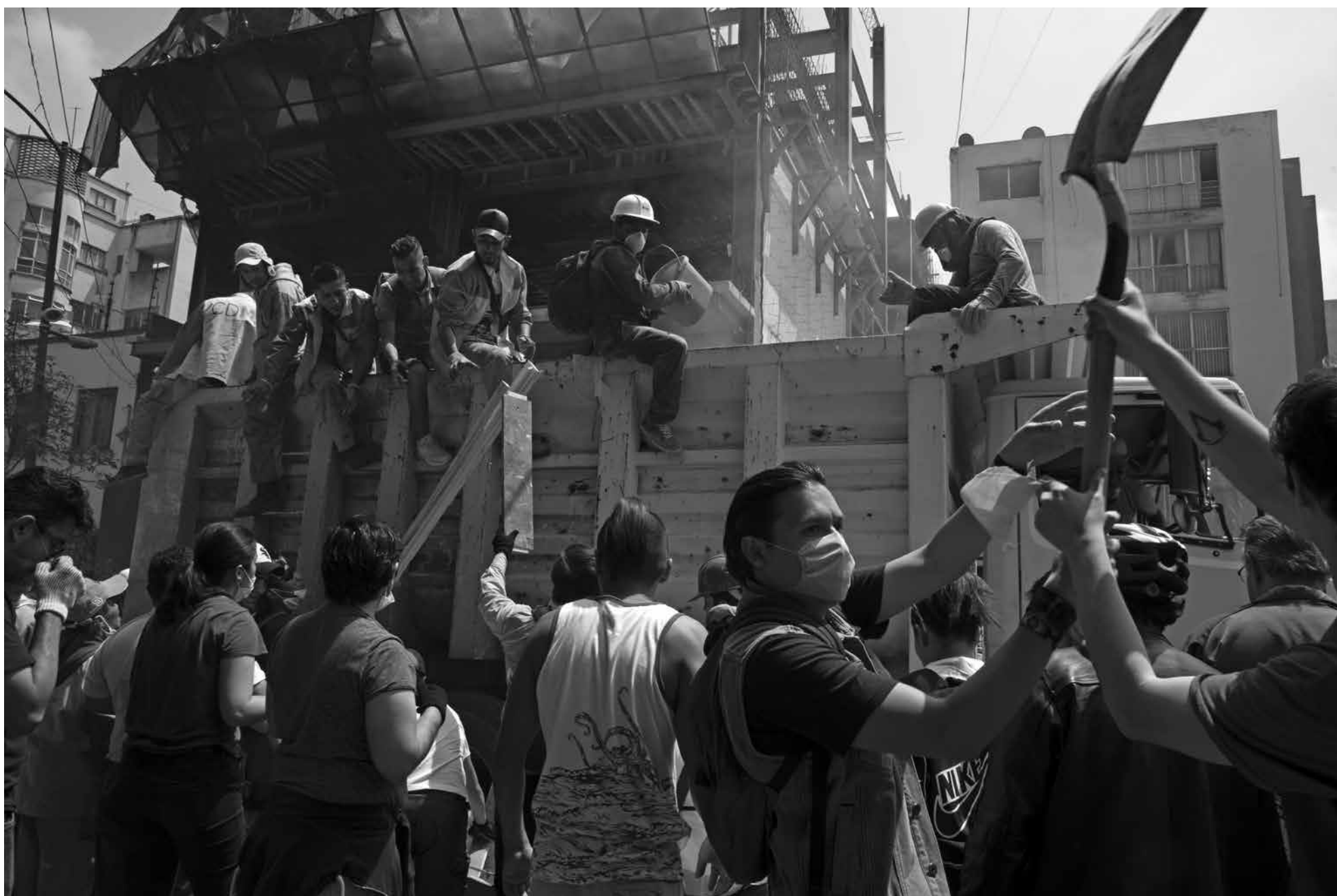
Voluntarios trabajan a marchas forzadas para sacar los escombros de un condominio derrumbado en la calle de Escocia. Colonia del Valle, Ciudad de México, 20 de septiembre de 2017. Foto: Israel Fuguemann.
