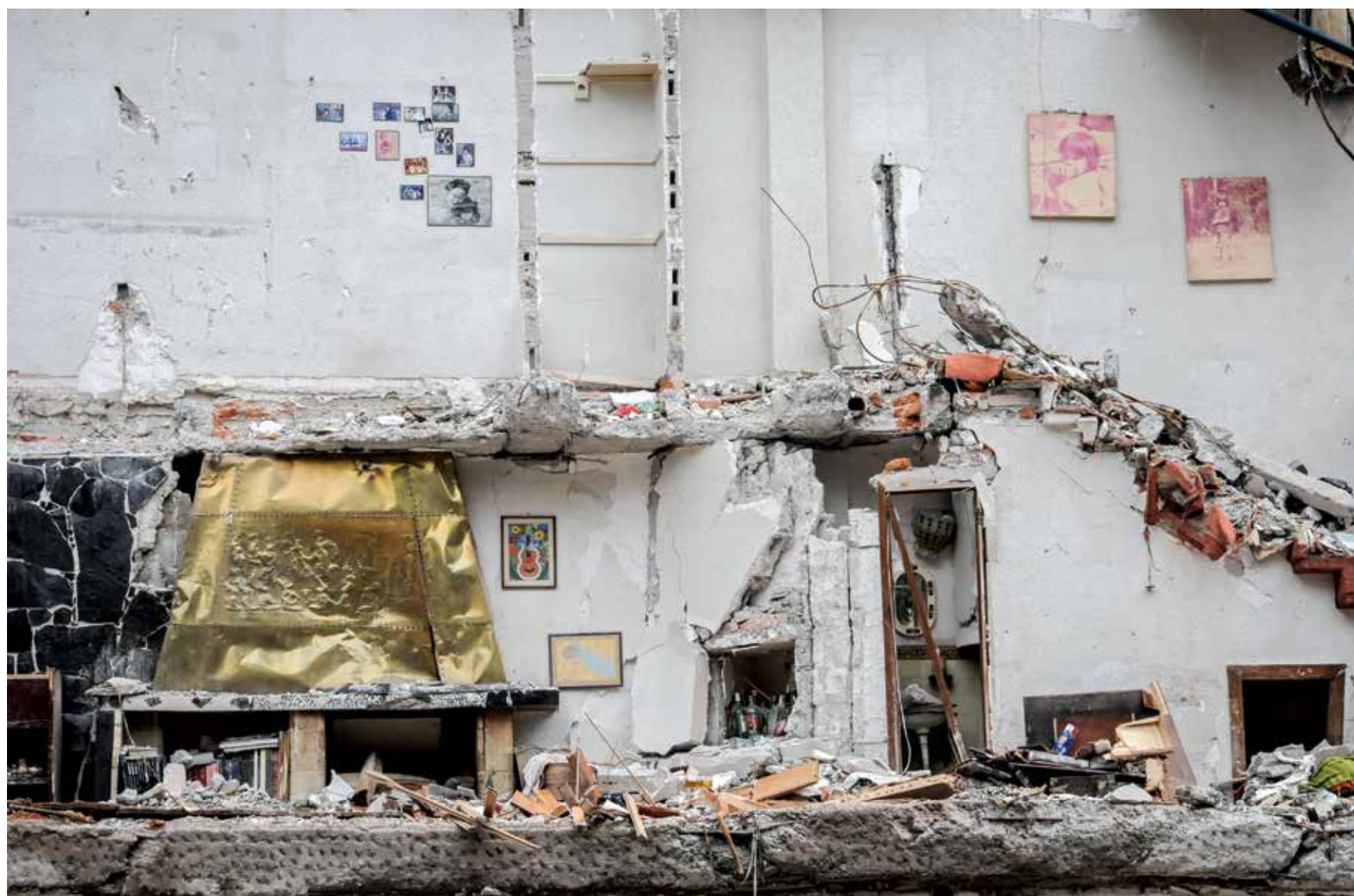
Retiro de escombros de un edificio colapsado en la esquina de Concepción Beistegui y Uxmal. Colonia Narvarte, Ciudad de México, 19 de septiembre del 2017. Foto: Diego Simón Sánchez.
