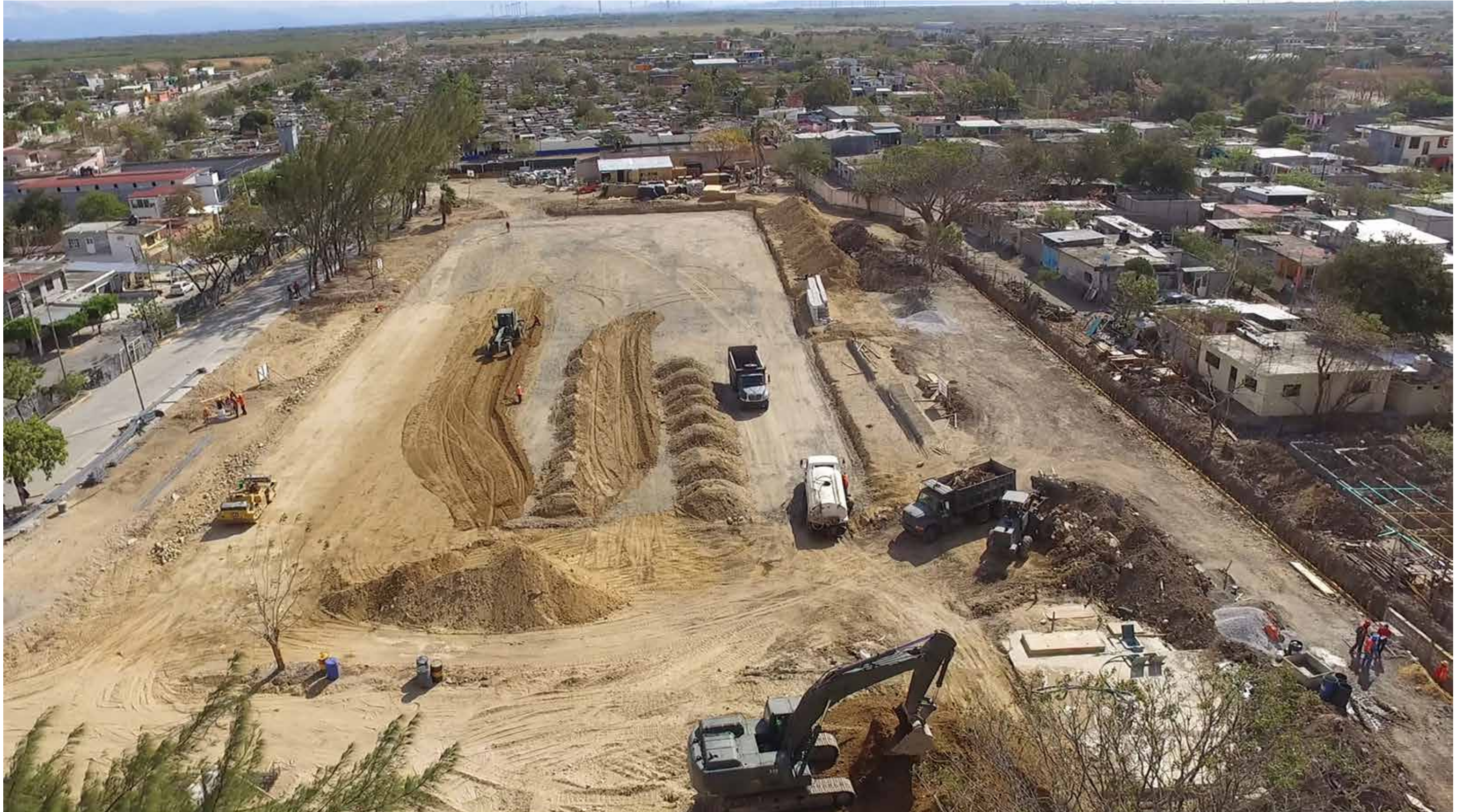
Reconstrucción del Hospital General Doctor Macedonio Benítez Fuentes. Juchitán, Oaxaca. Foto: Secretaría de la Defensa Nacional.
