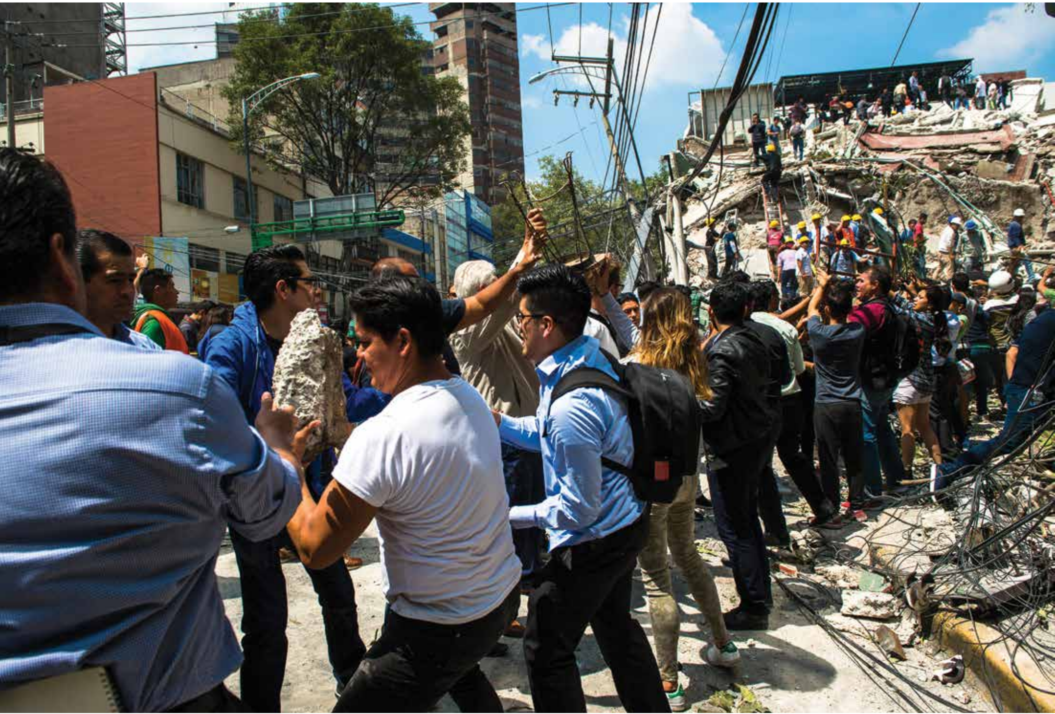
Jóvenes y adultos ayudan a retirar escombros de un edificio en la esquina de Medellín y San Luis Potosí, que se derrumbó cincuenta minutos después del sismo. Algunas personas que entraron a recuperar sus pertenencias quedaron atrapadas bajo los escombros. Colonia Roma, Ciudad de México, 19 de septiembre de 2017. Foto: Nicolás Tavira.
