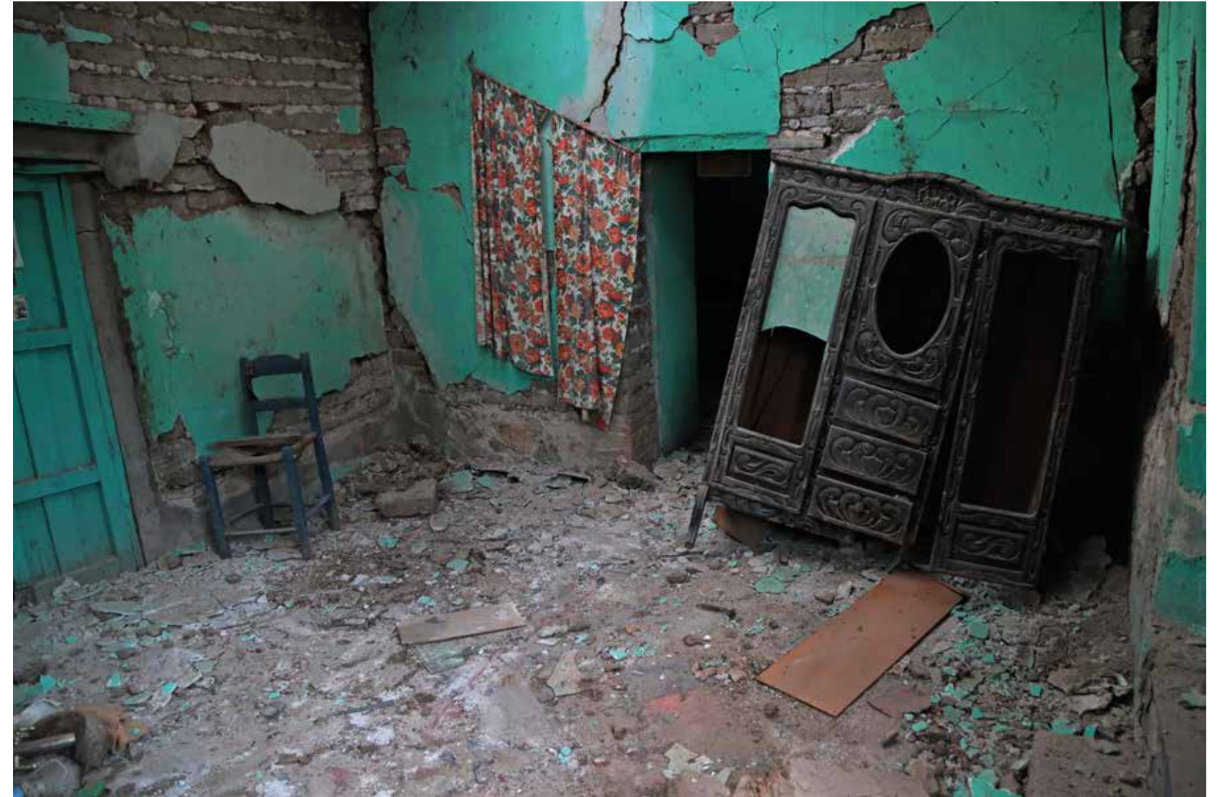
Casa construida con bloques de adobe que se vino abajo tras el sismo. Huitzuco de los Figueroa, Guerrero, 19 de septiembre de 2017. Foto: Jessica Torres Barrera.
