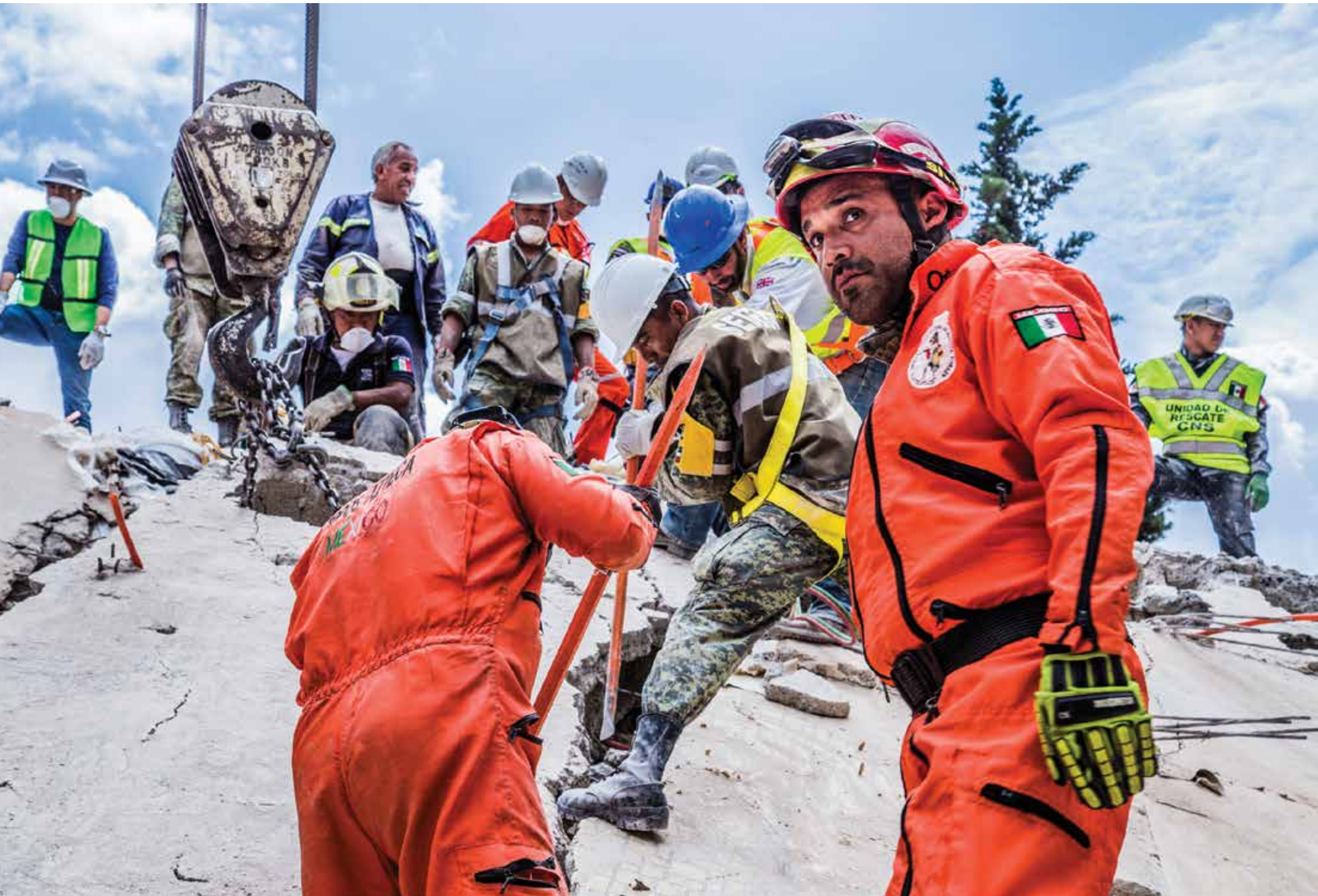
Equipo mixto –personal de la Marina y el Ejército, topes e ingenieros, entre otros– levanta losas. Colonia Del Valle, Ciudad de México, 24 de septiembre de 2017. Foto: Mauricio González Candela.
