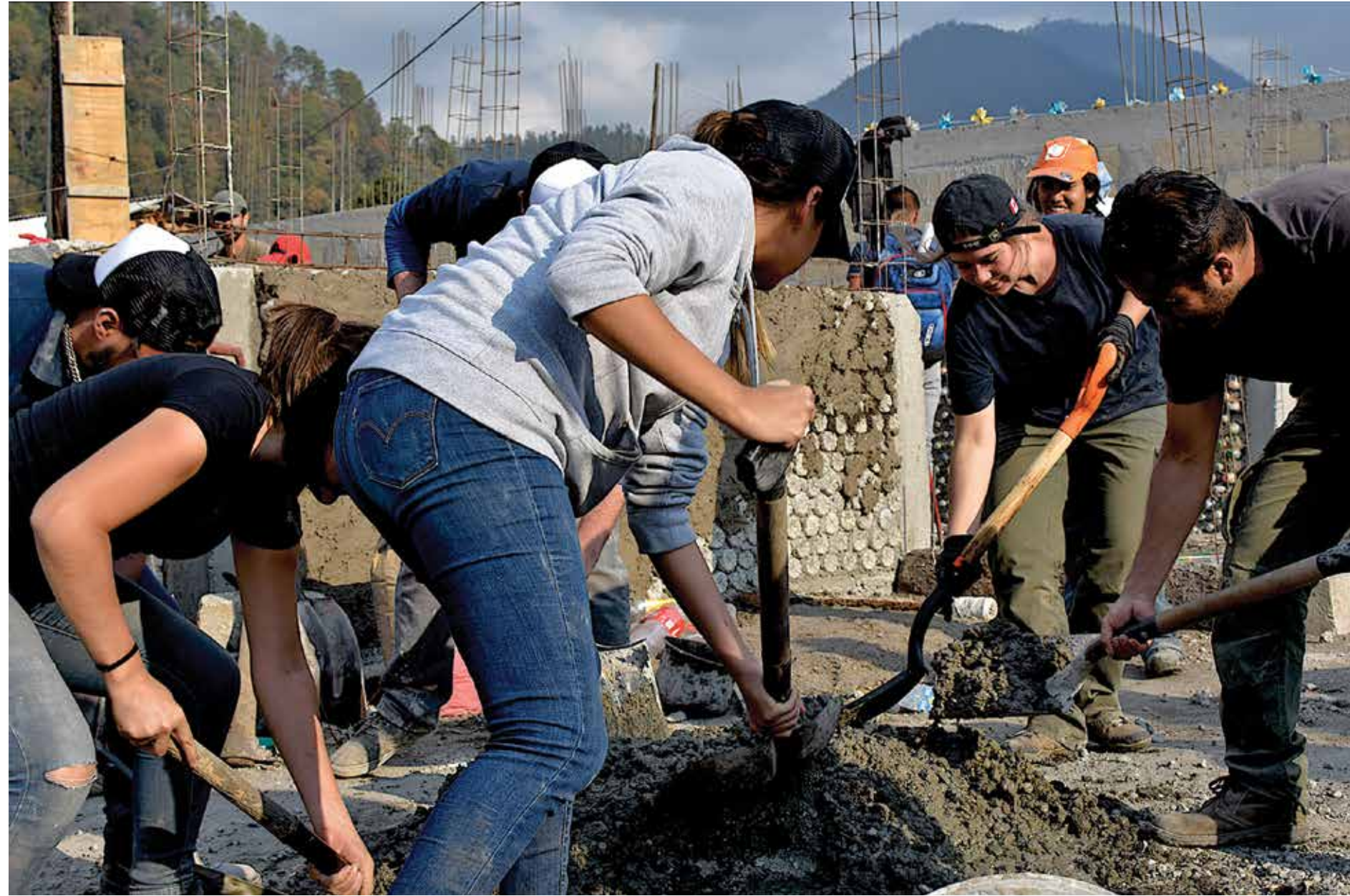
Voluntarios reconstruyen un hogar. Estado de México, 24 de febrero de 2018. Foto: Dafne Karina Gallardo Aceves / VIEM MX.
