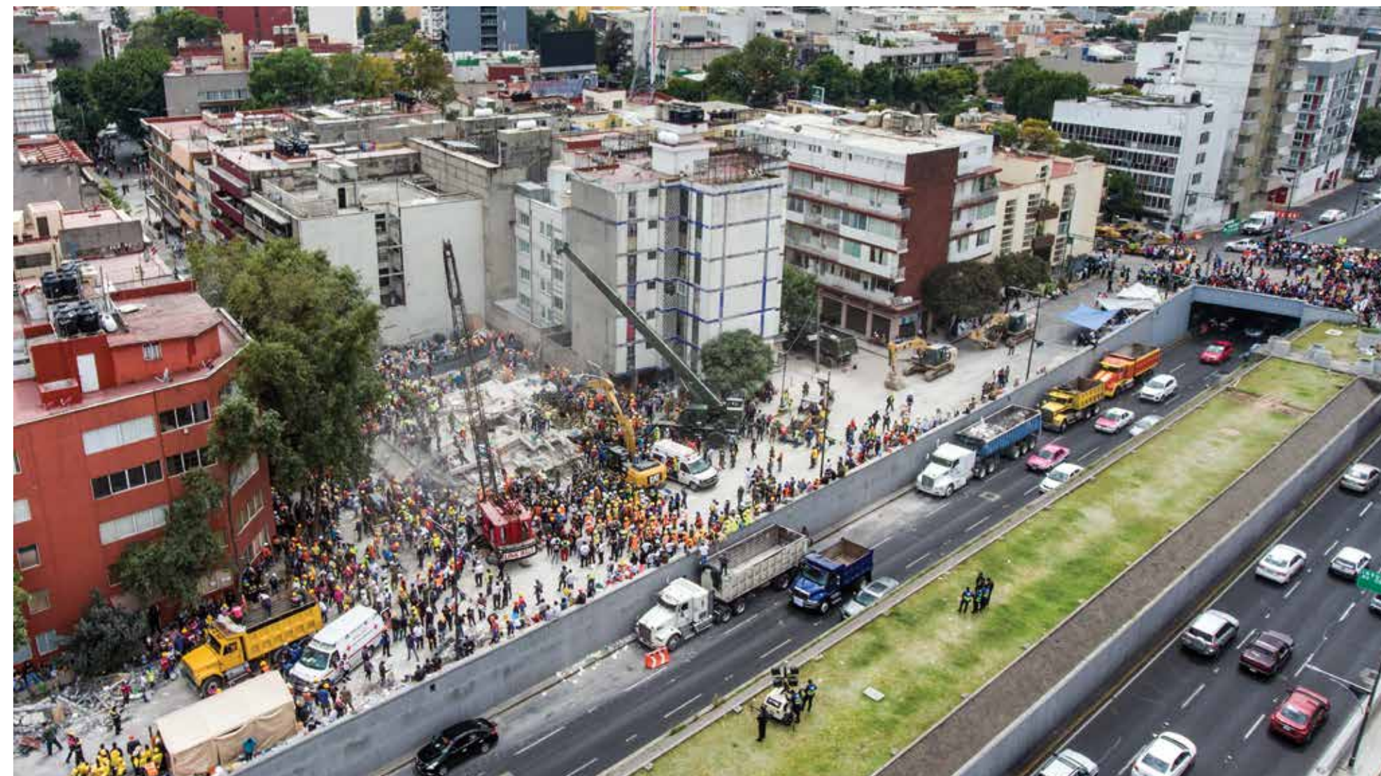
Edificio colapsado en la esquina del Viaducto y la calle de Torreón. Colonia Piedad Narvarte, Ciudad de México, 20 de septiembre de 2017. Foto: Contraste Media / NortePhoto .
