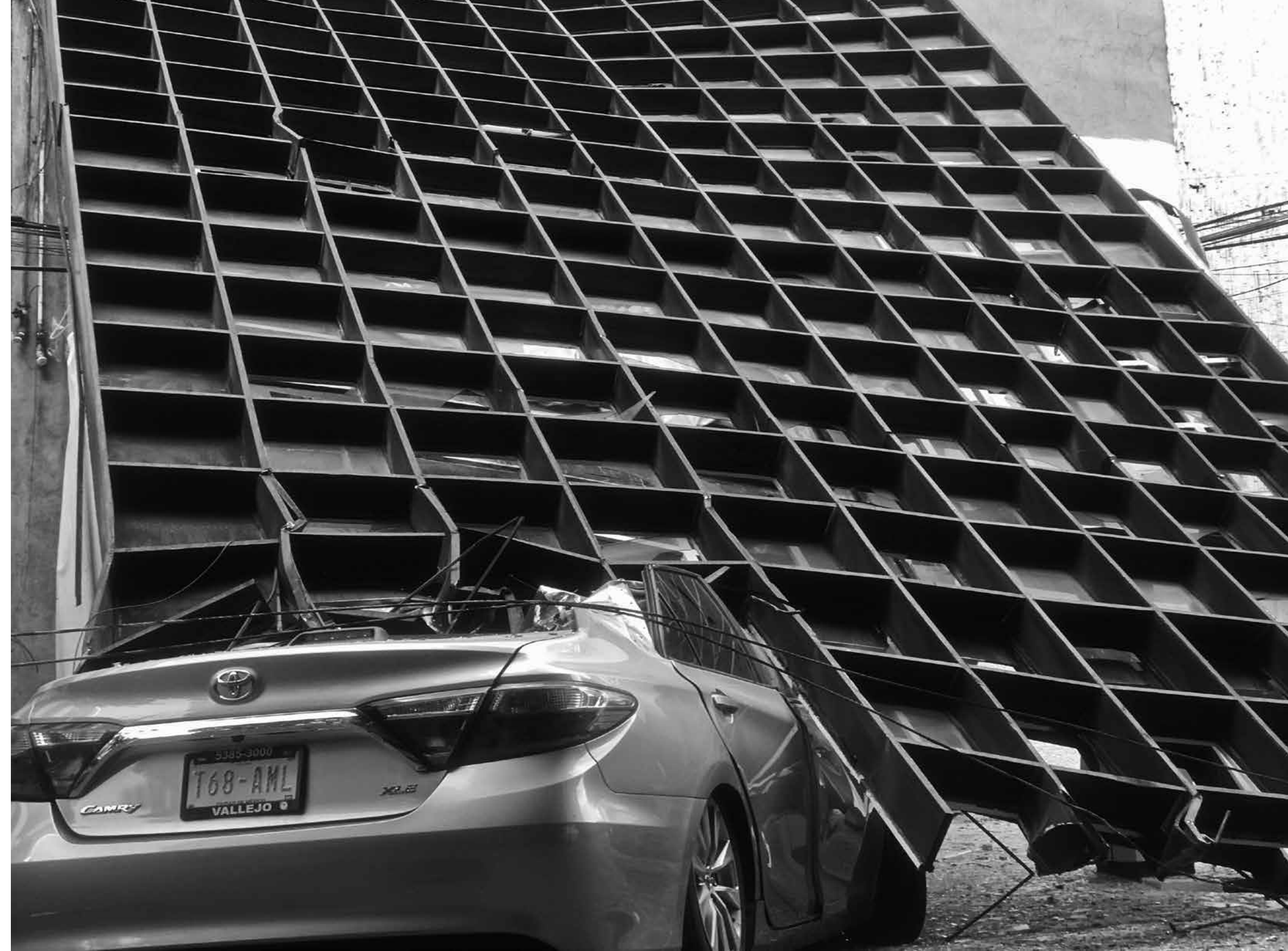
Auto aplastado segundos después del sismo bajo el frente de un edificio ubicado en la calle de Acapulco. La escena se reprodujo por medios digitales como Twitter, y fue objetivo de algunos fotoperiodistas. Colonia Roma, Ciudad de México, 19 de septiembre de 2017. Foto: Gabriel Vico.
