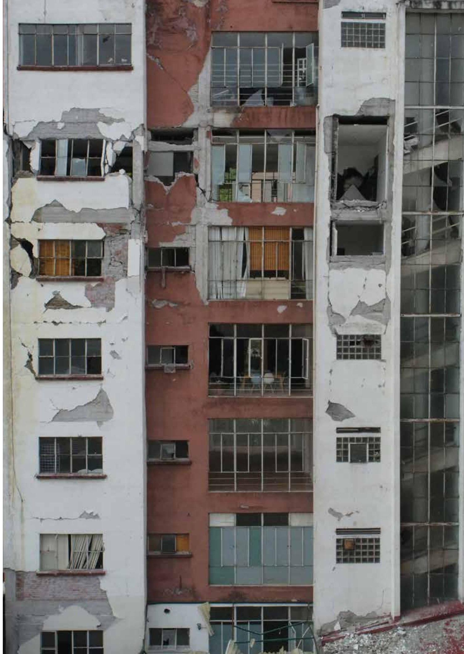
Fachada de edificio dañada por el sismo. Colonia Juárez, Ciudad de México, 28 de septiembre de 2017. Foto: Santiago Arau.
