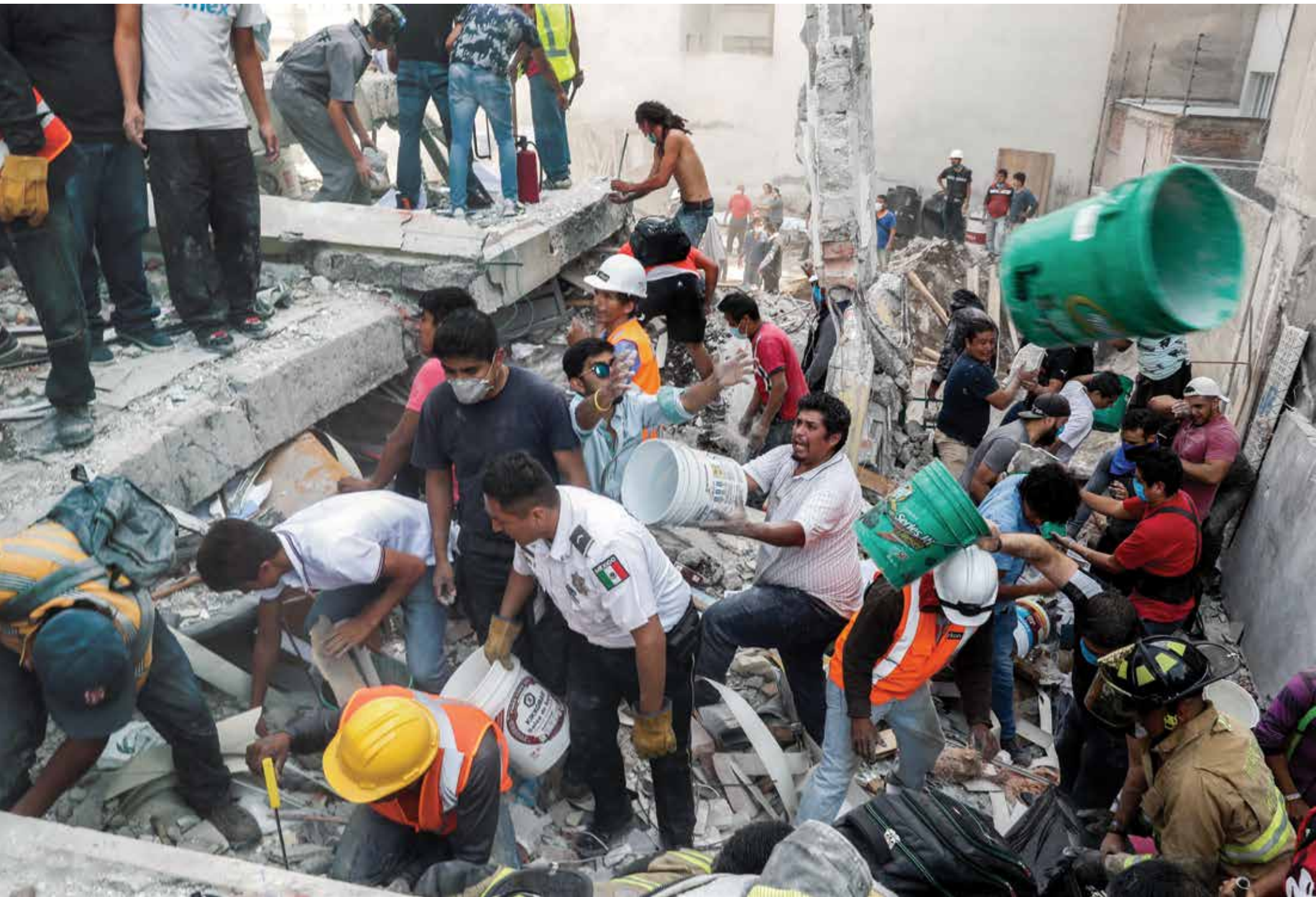
Voluntarios civiles trabajan a marchas forzadas para retirar escombros de un edificio colapsado en la calle de Torreón. Colonia Piedad Narvarte, Ciudad de México, 19 de septiembre de 2017. Foto: Christopher Rogel Blanquet / El Universal .
