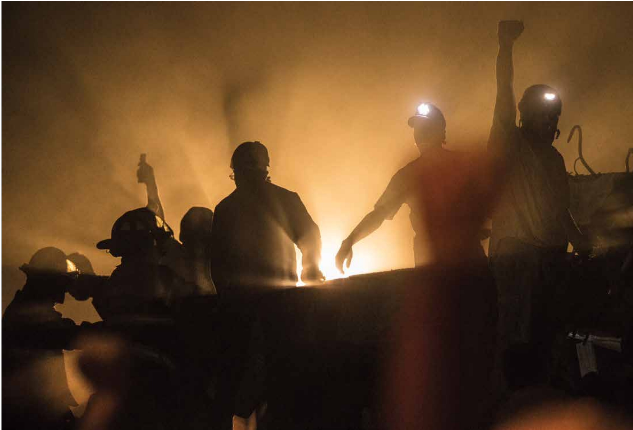
Operaciones de rescate del Heroico Cuerpo de Bomberos en un edificio en la esquina del Viaducto y la calle de Torreón. Colonia Piedad Narvarte, Ciudad de México, 19 de septiembre de 2017. Foto: Alfredo Martínez.
