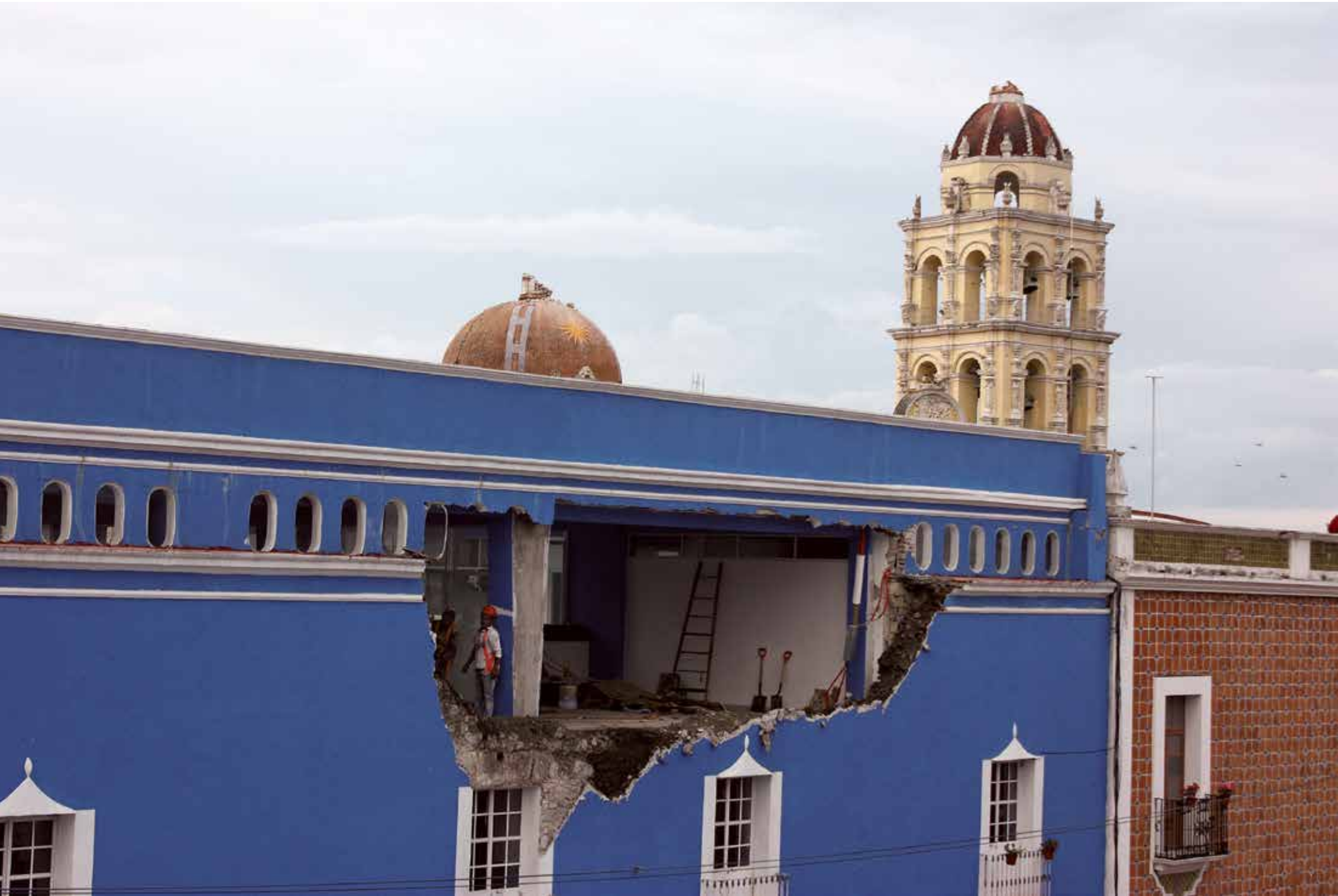
Edificio dañado por el terremoto en la esquina de la avenida Libertad y la calle 4 Oriente, en el centro de la ciudad de Atlixco. En un segundo plano aparece la parroquia de la Natividad de Nuestra Señora (del siglo XVII) con la cúpula y la torre dañadas. Al día siguiente del terremoto, los trabajadores retiran los restos de las paredes para empezar su reconstrucción. Atlixco, Puebla, 20 de septiembre de 2017. Foto: Antonio Lezama.
