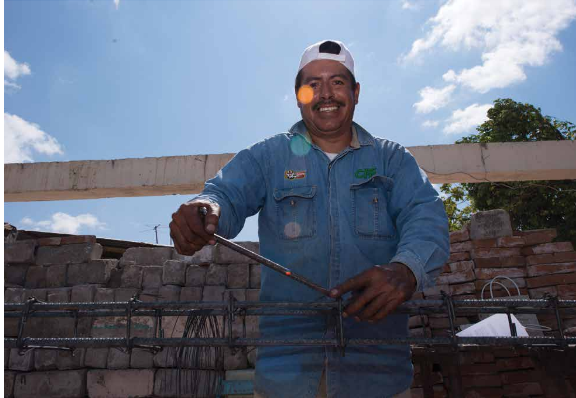
Con el mecanismo de autoconstrucción asistida, del Gobierno de la República, se reconstruyen viviendas afectadas por los sismos del 7 y el 19 de septiembre de 2017 en Chiapas. Foto: SEDATU Chiapas.
