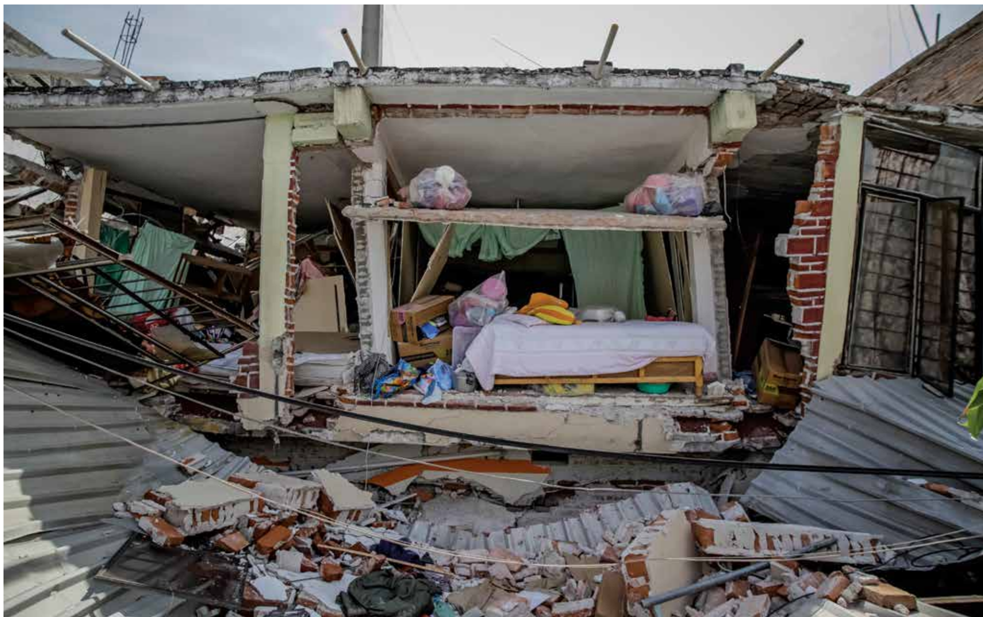
Habitación expuesta tras el derrumbe de la planta baja de la casa por el sismo. Jojutla, Morelos, 20 de septiembre de 2017. Foto: Carlos Díaz.
