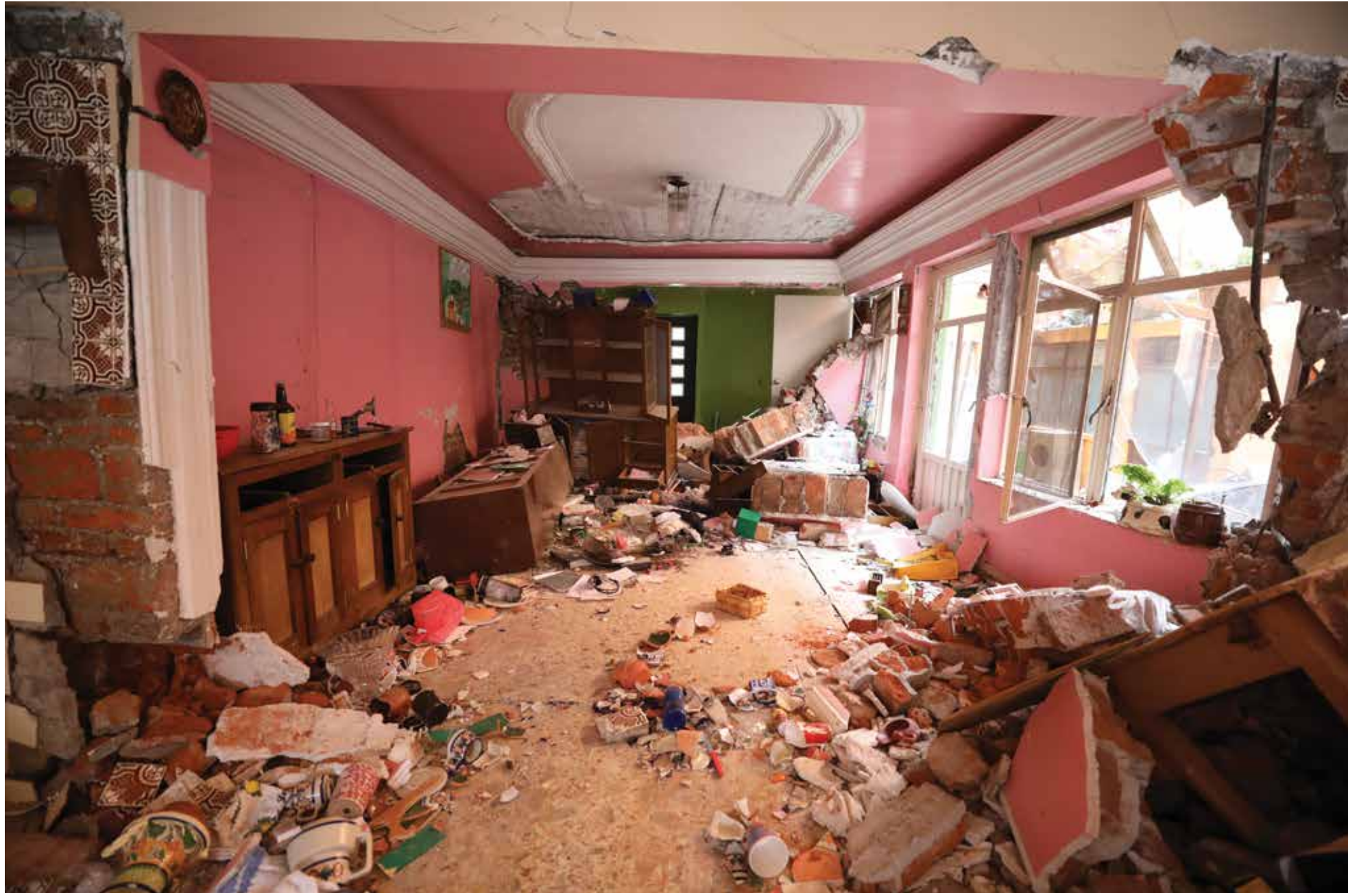
Interior de una casa semiderruida. San Gregorio Atlapulco, Ciudad de México, 25 de septiembre de 2017. Foto: Santiago Arau.
