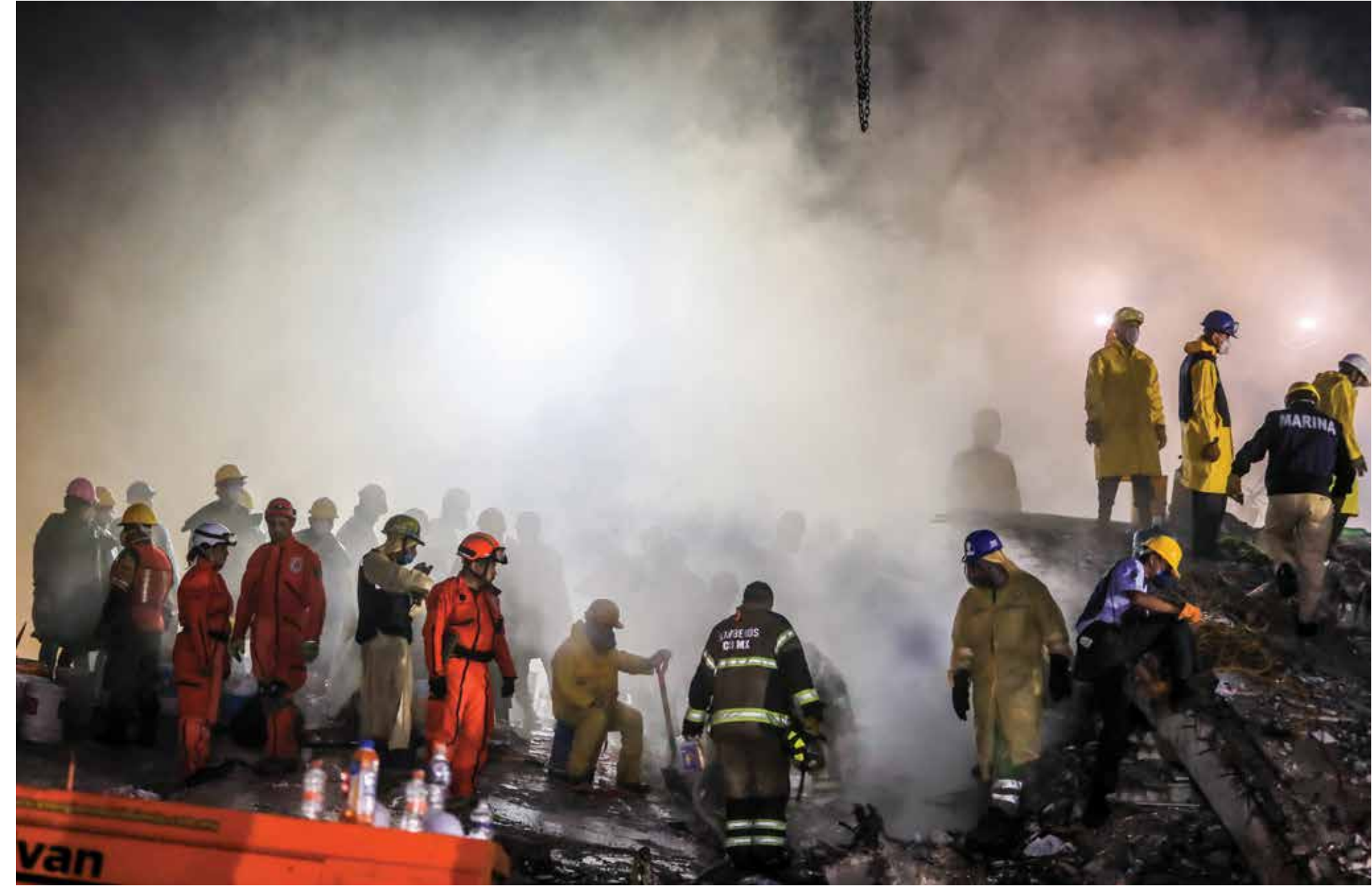
Bomberos, rescatistas y personal de la Marina trabajan de madrugada en un edificio colapsado en la avenida Emiliano Zapata. Colonia Emperadores, Ciudad de México, 21 de septiembre de 2017. Foto: Luis Gutiérrez / NortePhoto.com.
