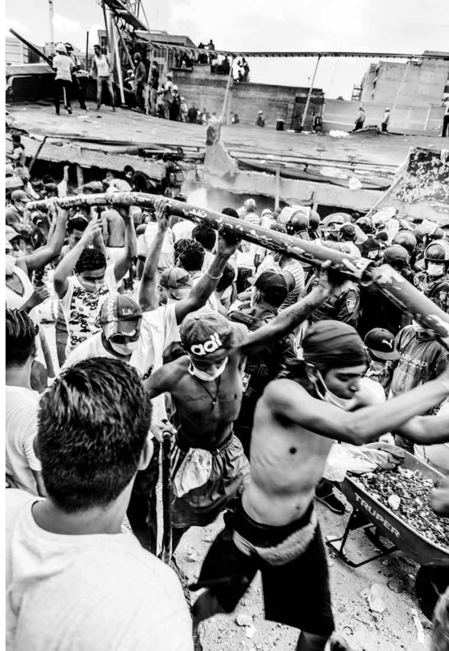
Voluntarios retiran parte de la tubería de la fábrica de textiles ubicada en la calle de Chimalpopoca esquina con Bolívar. Colonia Obrera, Ciudad de México, 19 de septiembre de 2017. Foto: Daniel Orozco.
