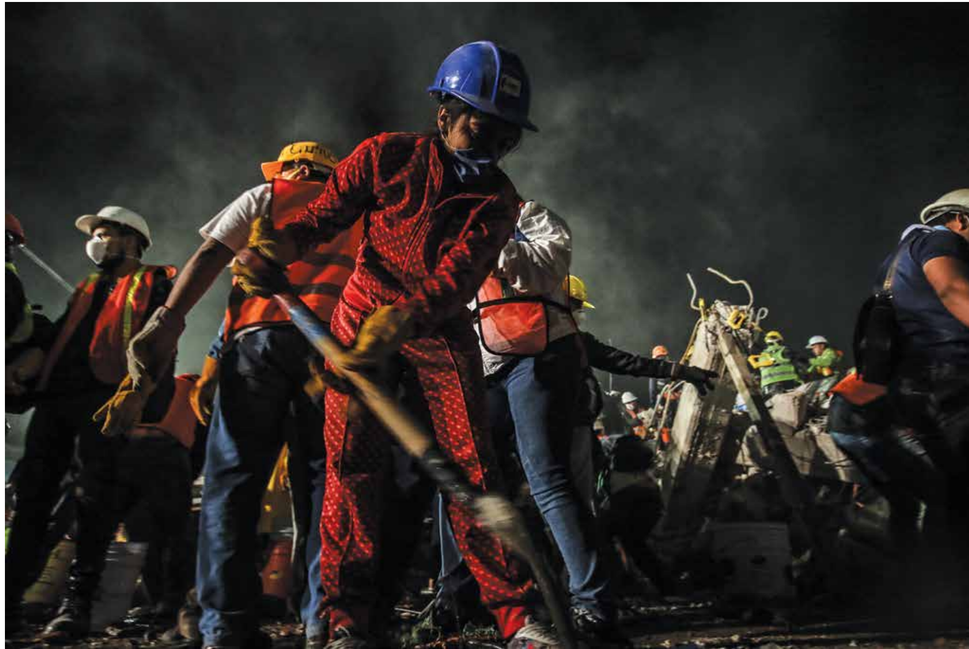
Una adolescente limpia las inmediaciones del edificio derrumbado en la esquina de Bolívar y Chimalpopoca para agilizar las labores de rescate. Colonia Obrera, Ciudad de México, 21 de septiembre de 2017. Foto: José Luna.
