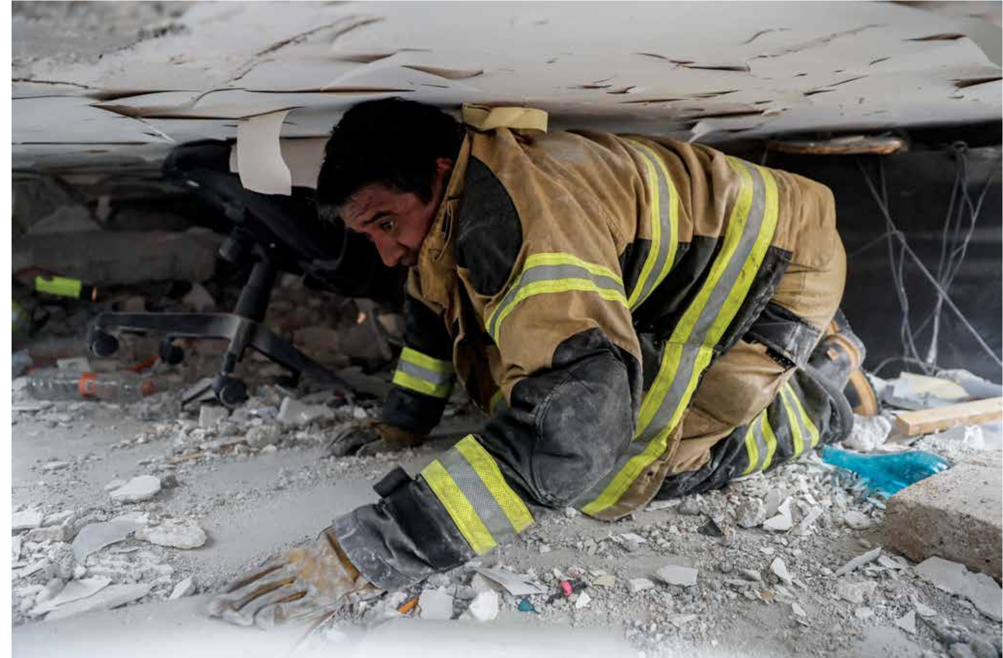
Bombero maniobra bajo una estructura colapsada en la esquina del Viaducto y la calle Torreón. Colonia Piedad Narvarte, Ciudad de México, 19 de septiembre de 2017. Foto: Christopher Rogel Blanquet / El Universal .
