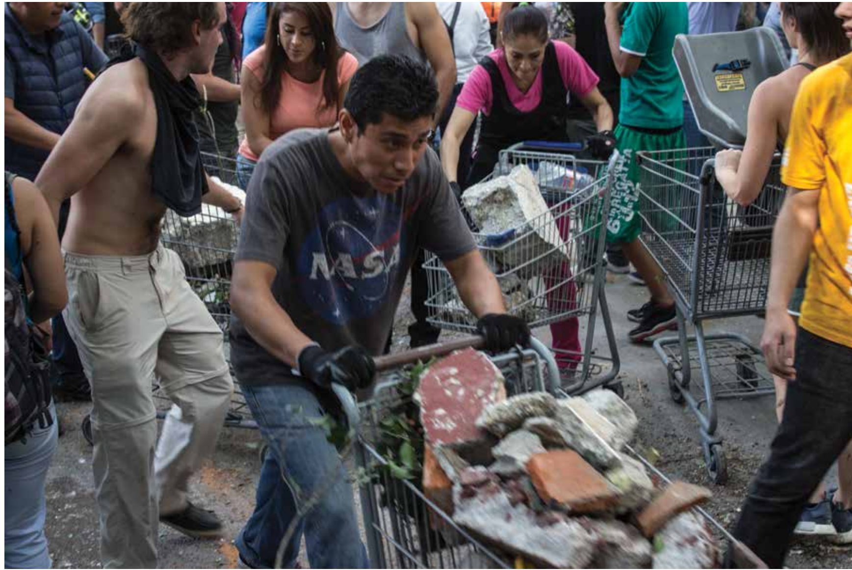
Carritos del supermercado sirven de carretillas para retirar los escombros de un edificio derrumbado en la calle de Ámsterdam. Colonia Condesa, Ciudad de México, 19 de septiembre de 2017. Foto: J.M. Mariscal.
